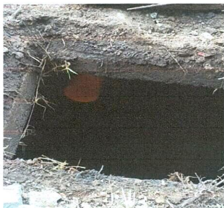
Foto 3: Red de Drenaje
